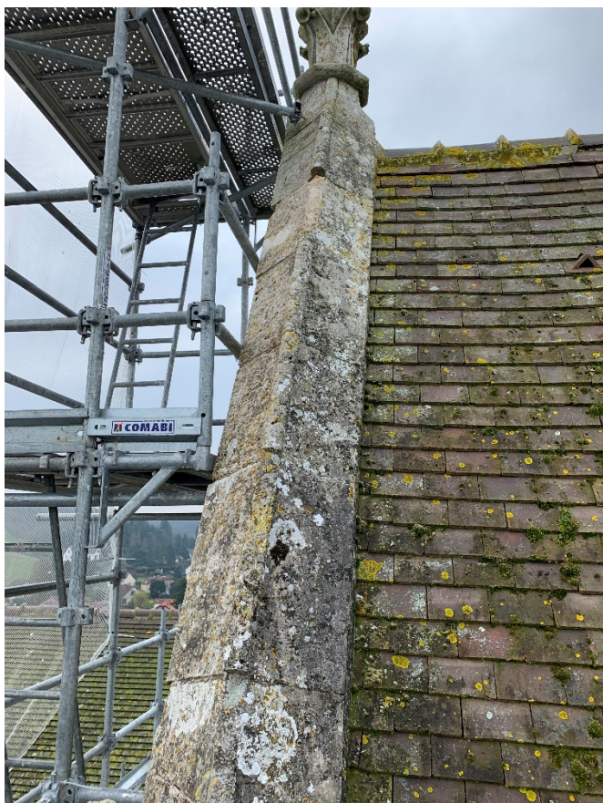
Etat initial de l'arête, le profil mouluré est altéré.
