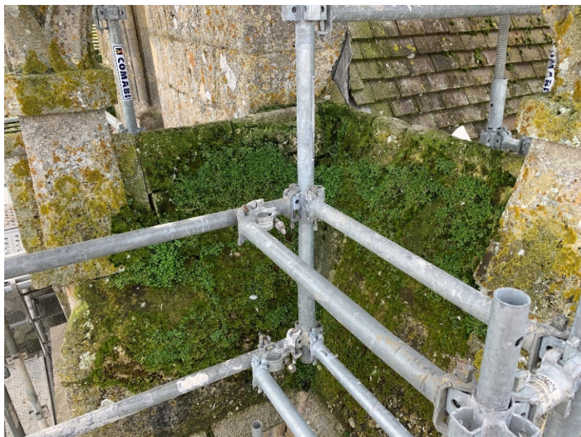
Etat initial des culées envahies de végétation.
